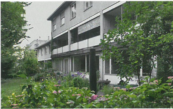
Die Fassade aus den 1960er-Jahren vor der Sanierung mit den alten Eternitbrüstungen und Sonnenstoren.
